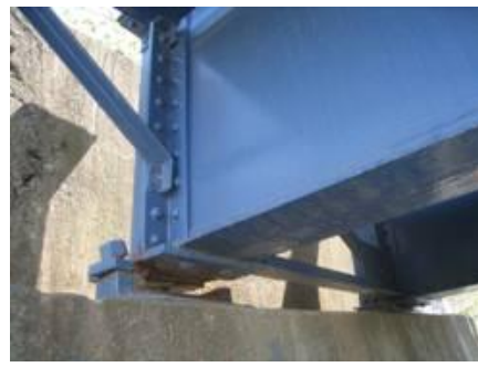
図 2-24 下流右岸支承部
