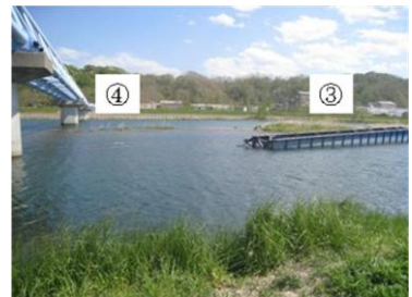
図 2-20 流失した桁③及び④
