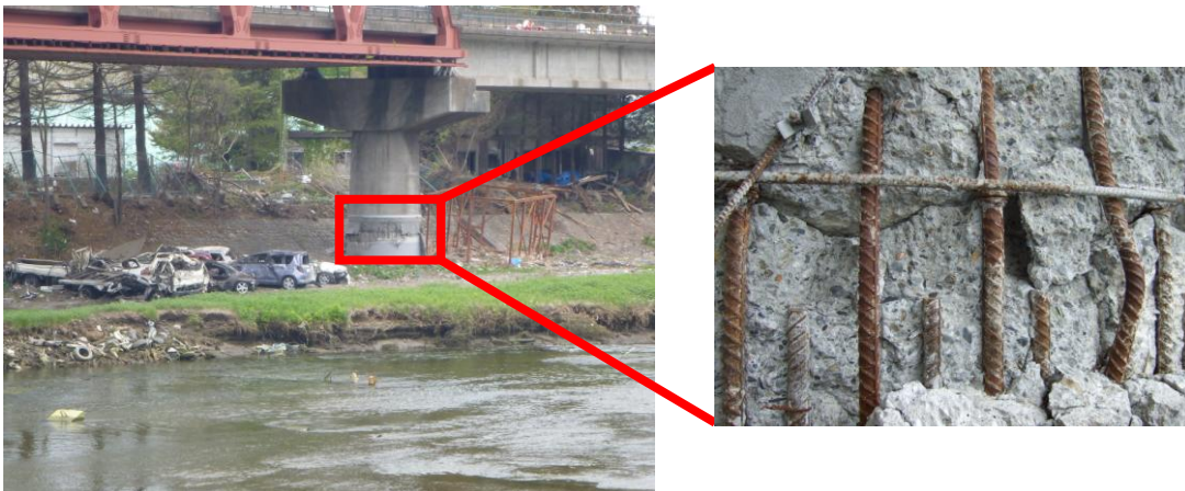
図 3-2 座屈した橋脚
