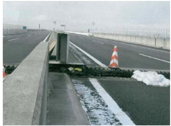
図 1-2 ジョイント部に生じた段差
