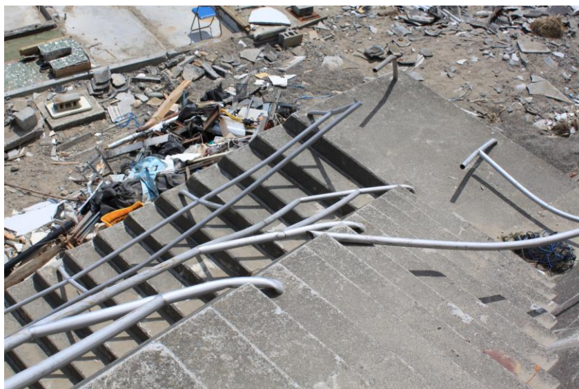
図 2-10 手すりのねじ曲がった階段
