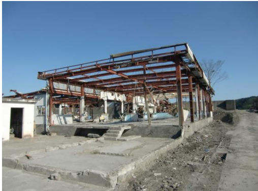
図 2-34 鉄骨のみが残る建物
