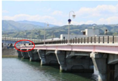
図 2-25 下流側の道路高架橋の欄干の被害状況
