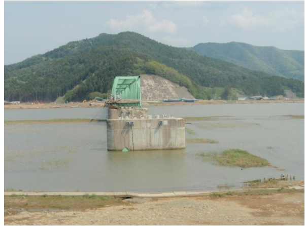
図 1-8 2径間が流出した様子
