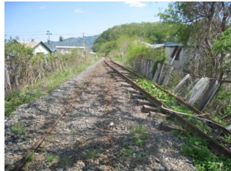
図 2-22 横に引っ張られたレール(右岸)
