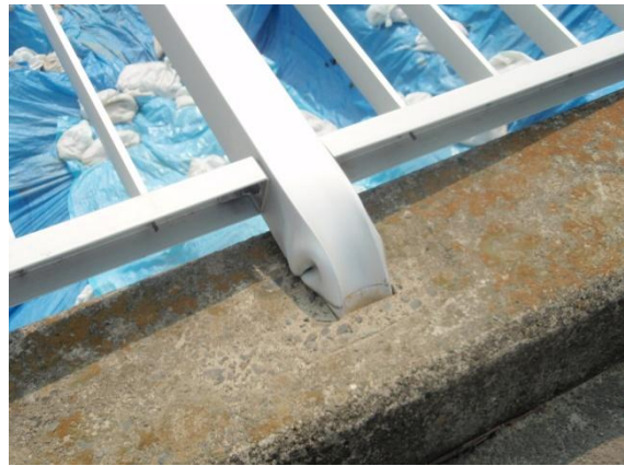
図 1-10 津波によって曲げられた柵
