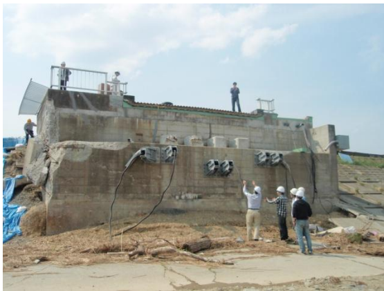
図 1-9 ケーブルの破断した橋脚部
