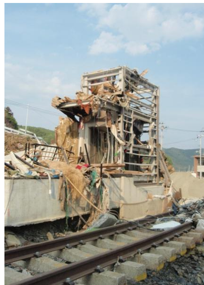
図 1-14 破壊された駅のエレベーター
