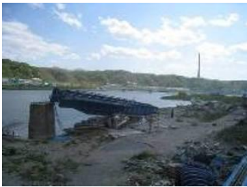
図 2-18 流失した桁①
