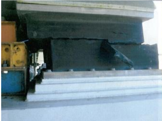
図 1-1 破断したゴム支承
